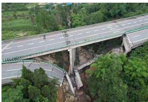
图10 恩广高速达万段6号大桥倒塌事故 [52]
