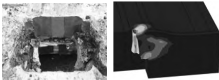
(a)混凝土板局部压溃
